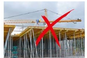
2 Interdit: coffrage de dalle de grande hauteur sans protection antichute.
